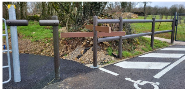
Barrière passage piéton et vélo
