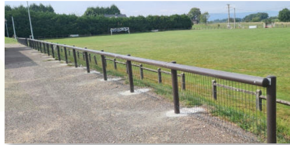
Barrière main-courante + sécurisation avec panneau grillagé
